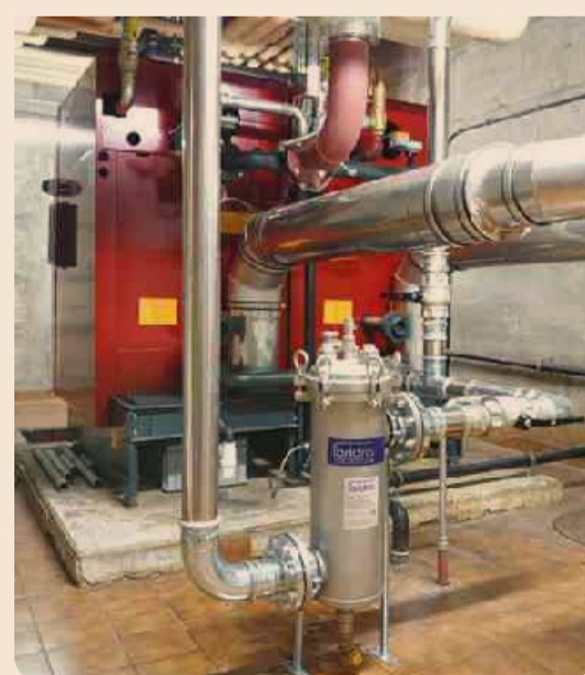
Filtro IDRAMAG installato in centrale termica
