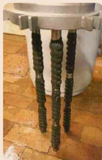
Apertura e pulizia del filtro defangatore IDRAMAG
