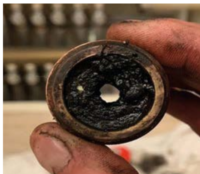
Sezione del tubo quasi ostruito
