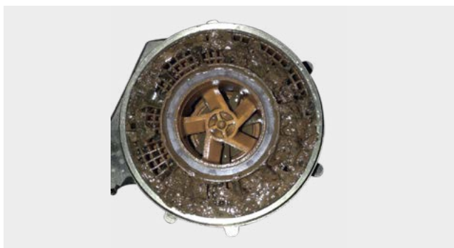
Esempio di contabilizzatore di calore intasato dagli ossidi.
